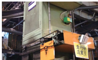
自動配湯装置
